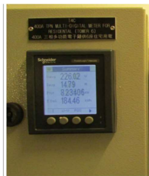
照片 A.12 400A 電路計量裝置
