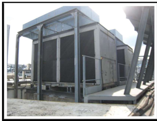
照片 A.10 風冷式冷水機
