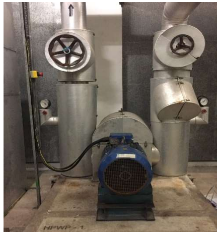
照片 A.11 冷凍水泵
