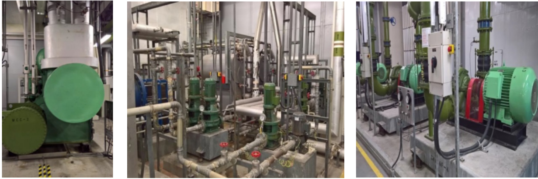
照片A.17冷水机组设备
